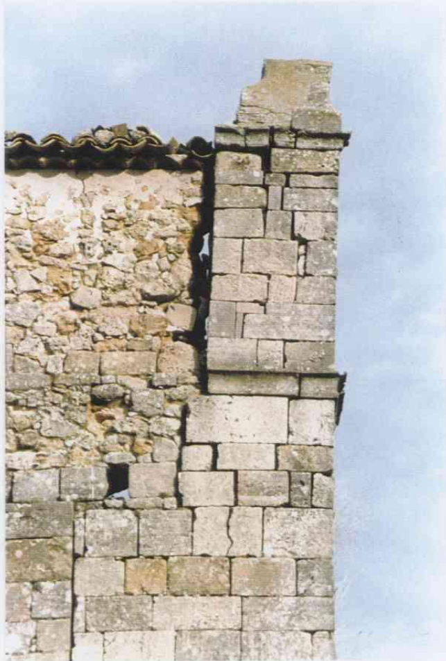
FOTO 18: Desplome de la espadaña
