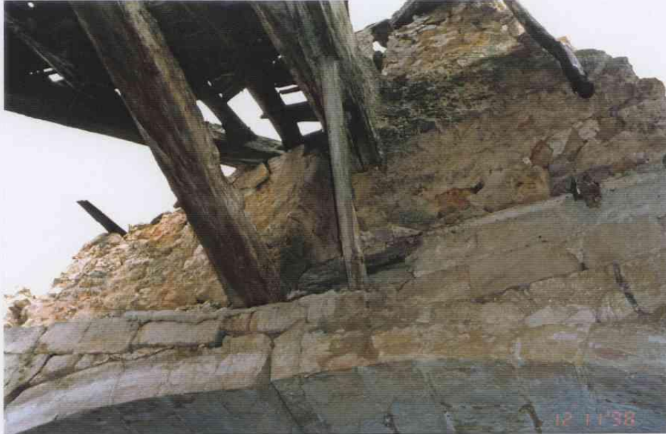
FOTO 14: Detalle del hundimiento de la cubierta del último tramo de la nave
