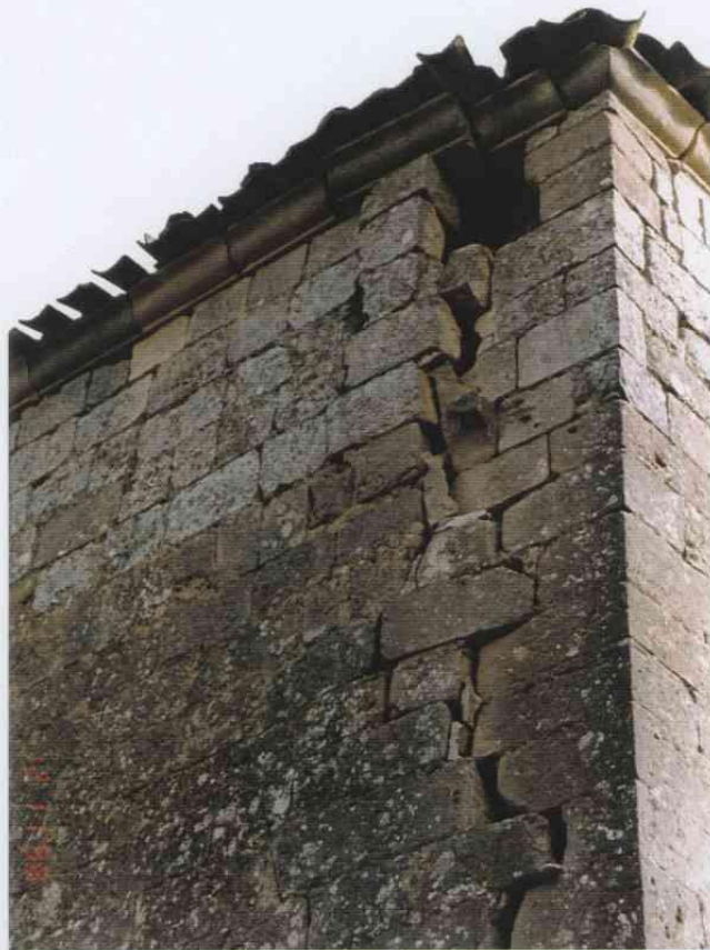
FOTO 19: Detalle del muro Norte en la zona de hundimiento de la cubierta del coro de la Iglesia.
