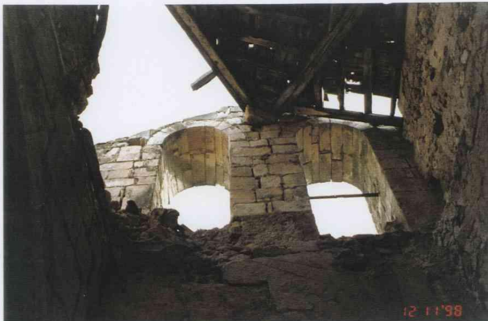
FOTO 16: Estado actual del interior de la espadaña
