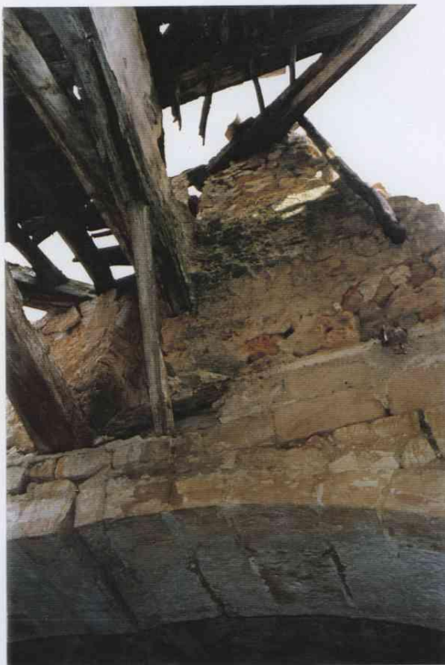
FOTO 17: Estado actual del arco de piedra de los pies de la nave
